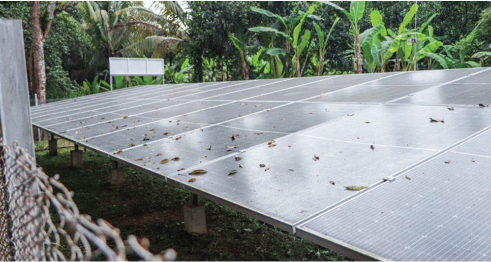
▲ Panel Surya pada PLTS Irigasi Karang Raja
