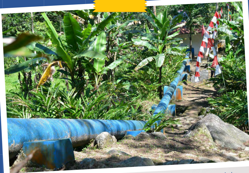
Pipa untuk mengalirkan air ke Pembangkit Listrik Tenaga Mikro Hidro (PLTMH) di Desa Karangtengah, Kec. Cilongok, Kab. Banyumas, Jawa Tengah (Dokumentasi: IESR)
