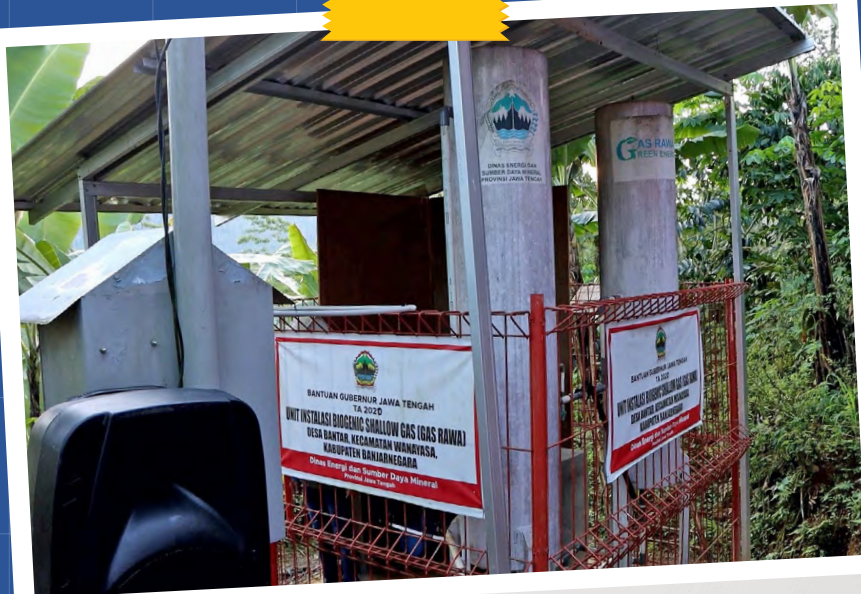
Instalasi pemisahan gas dan air pada Biogenic Shallow Gas di Desa Bantar, Kecamatan Wanayasa, Banjarnegara (Dokumentasi: IESR)
