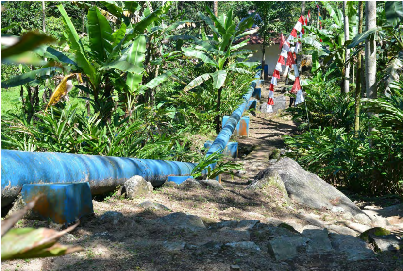
Pipa untuk mengalirkan air ke Pembangkit Listrik Tenaga Mikro Hidro (PLTMH) di Desa Karangtengah, Kec. Cilongok, Kab. Banyumas, Jawa Tengah.
