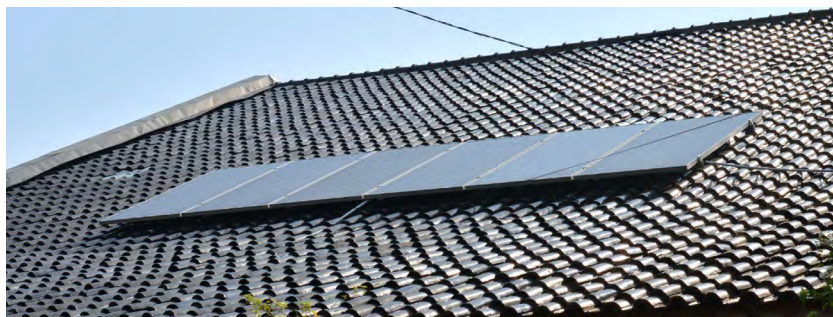
Instalasi PLTS atap Desa Senenan, Kec. Tahunan, Kab. Jepara, Jawa Tengah.
