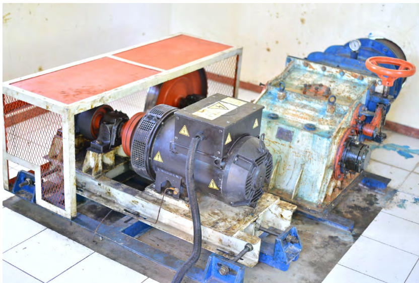
Turbin dan generator pada Pembangkit Listrik Tenaga Mikro Hidro (PLTMH) Desa Karangtengah, Kec. Cilongok, Kab. Banyumas, Jawa Tengah.
