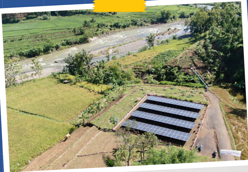
Pompa Air Tenaga Surya (PATS) tampak berdekatan dengan Sungai Tajum, Desa Kaliurip. (Dokumentasi: IESR)
