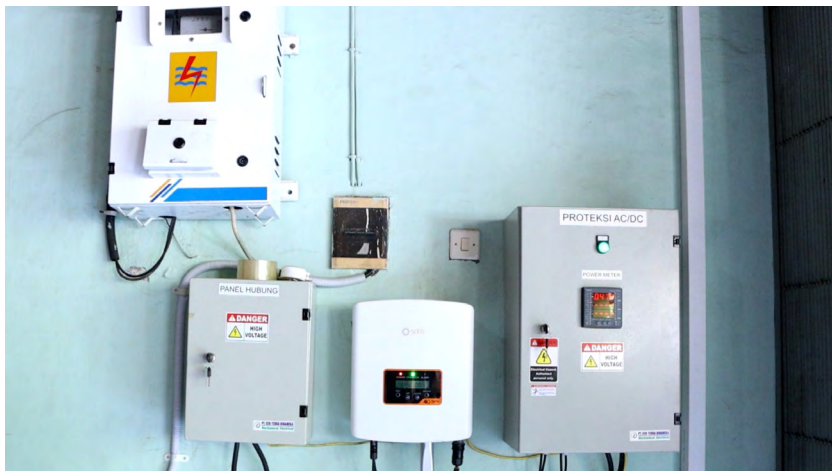
Kontrol Panel PLTS atap di rumah pengrajin ukir relief kayu Desa Senenan, Kec. Tahunan, Kab. Jepara, Jawa Tengah.
