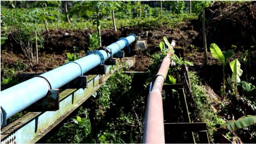
Saluran pipa air dari Sungai Tajum menuju persawahan Warga Desa Kaliurip, Kecamatan Purwojati, Kabupaten Banyumas, Jawa Tengah.
